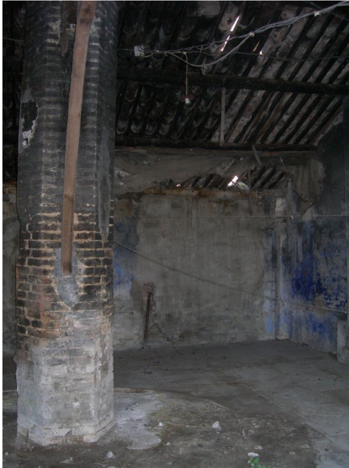
Interno locale deposito ( visibile lo stato di degrado della copertura)
