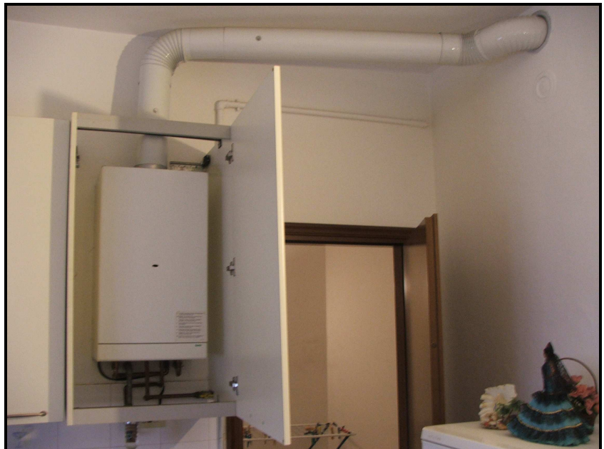
Foto 11: Caldaia interna nel locale cucina / soggiorno.
