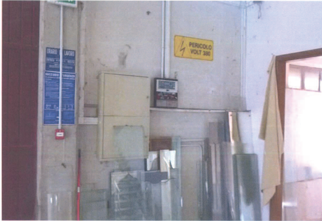
31 – VISTA DELL'INTERNO DEL FABBRICATO, IMPIANTO ELETTRICO
