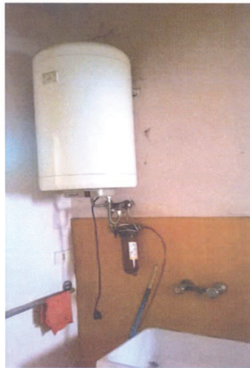
30 – VISTA DELL'INTERNO DEL FABBRICATO, IMPIANTO ACQUA CALDA
