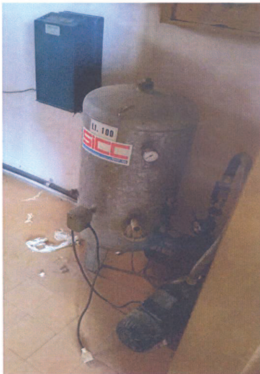
29 – VISTA DELL'INTERNO DEL FABBRICATO, IMPIANTO RISCALDAMENTO
