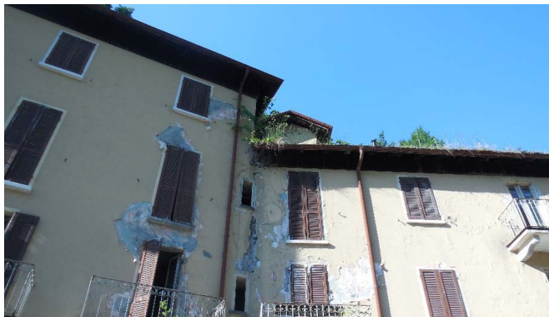
Figura 5 – PARTICOLARE FENOMENO ESFOGLIAZIONE
