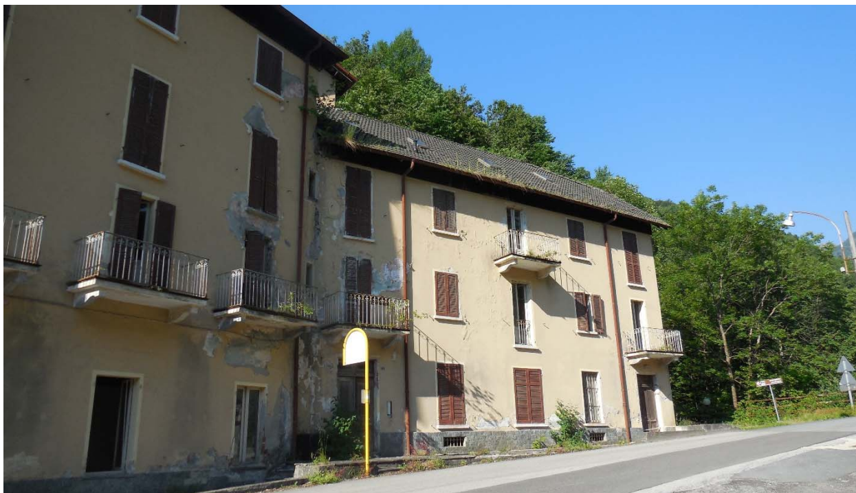
Figura 4 - LATO NORD - EVIDENTI FENOMENI DI ESFOGLIAZIONE SU TUTTA LA FACCIATA
