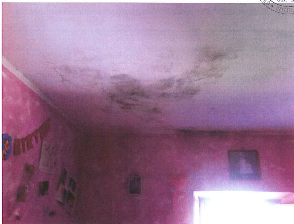
Foto 16 - Fenomeni di muffe e condensa nella Camera Doppia
