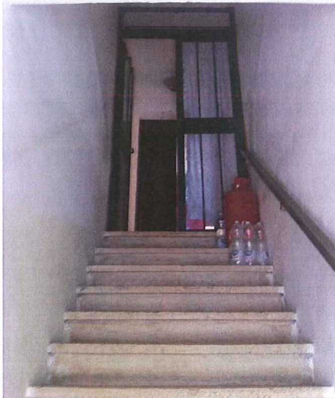
Foto 4 – Vista della chiusura del pianerottolo
