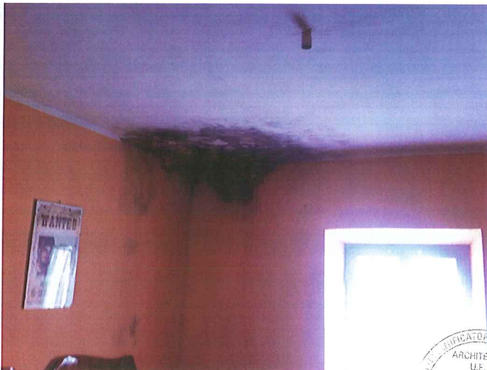
Foto 15 - Fenomeni di muffe e condensa nella Camera Matrimoniale
