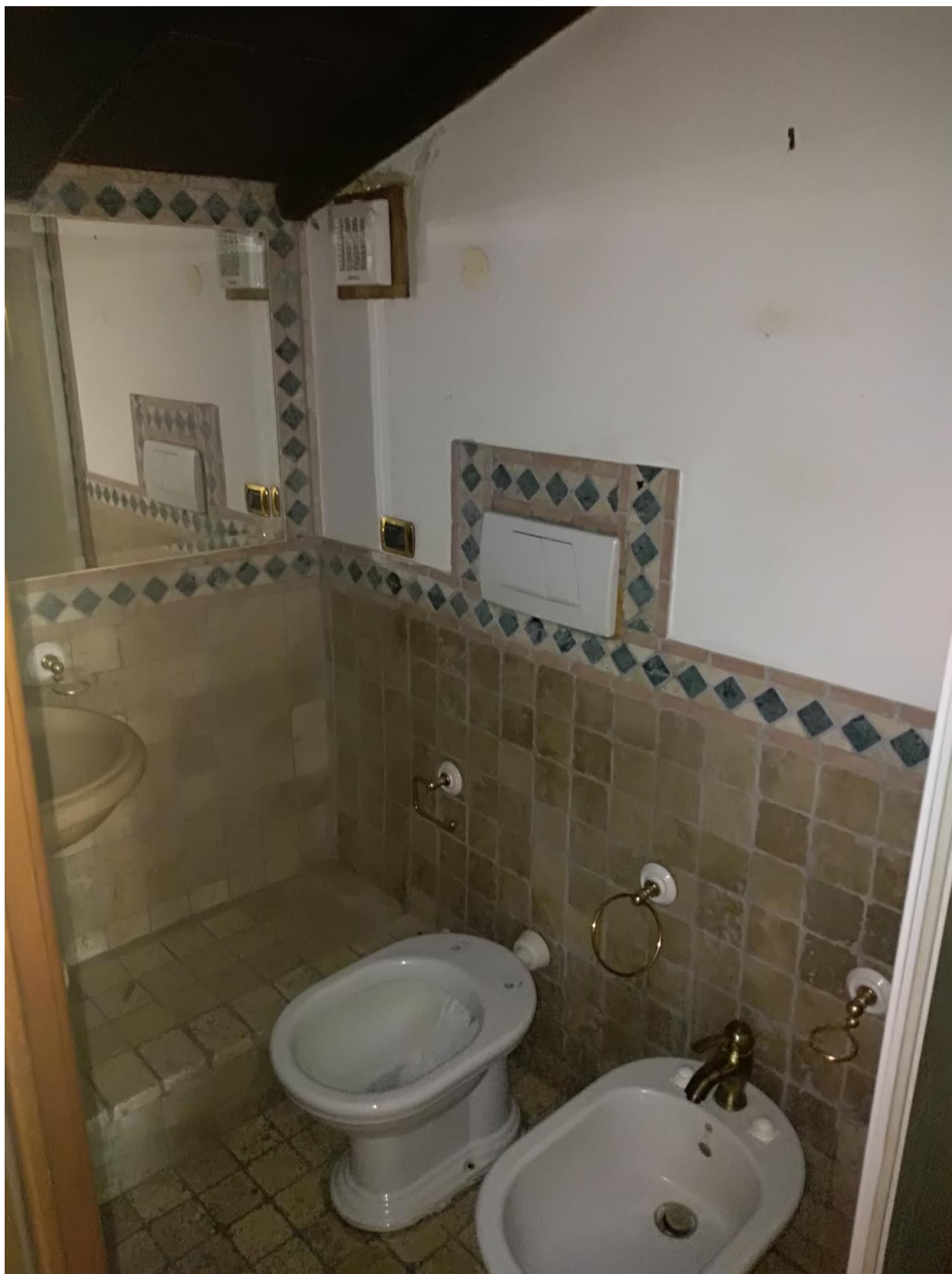
Bagno sprovvisto di finestra ma provvisto di sistema di aspirazione
