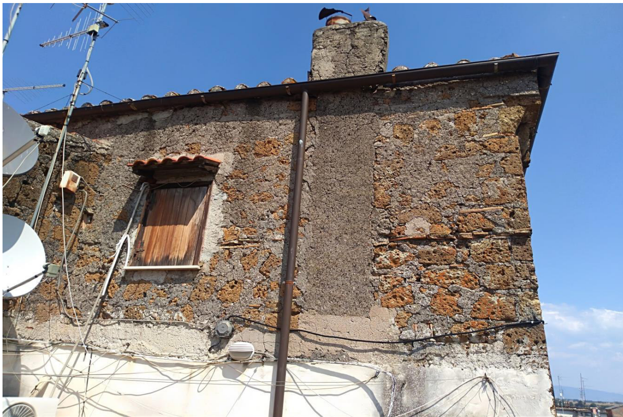
Vista dal terrazzo della facciata, bisognosa di ripristino.
