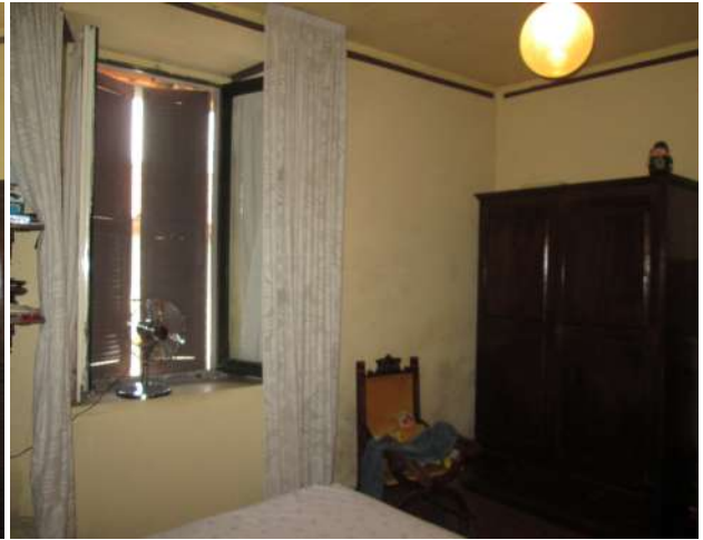
2021 ammaloramento delle pareti
