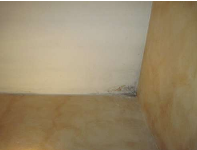
Plafone scala con infiltrazione 2014
