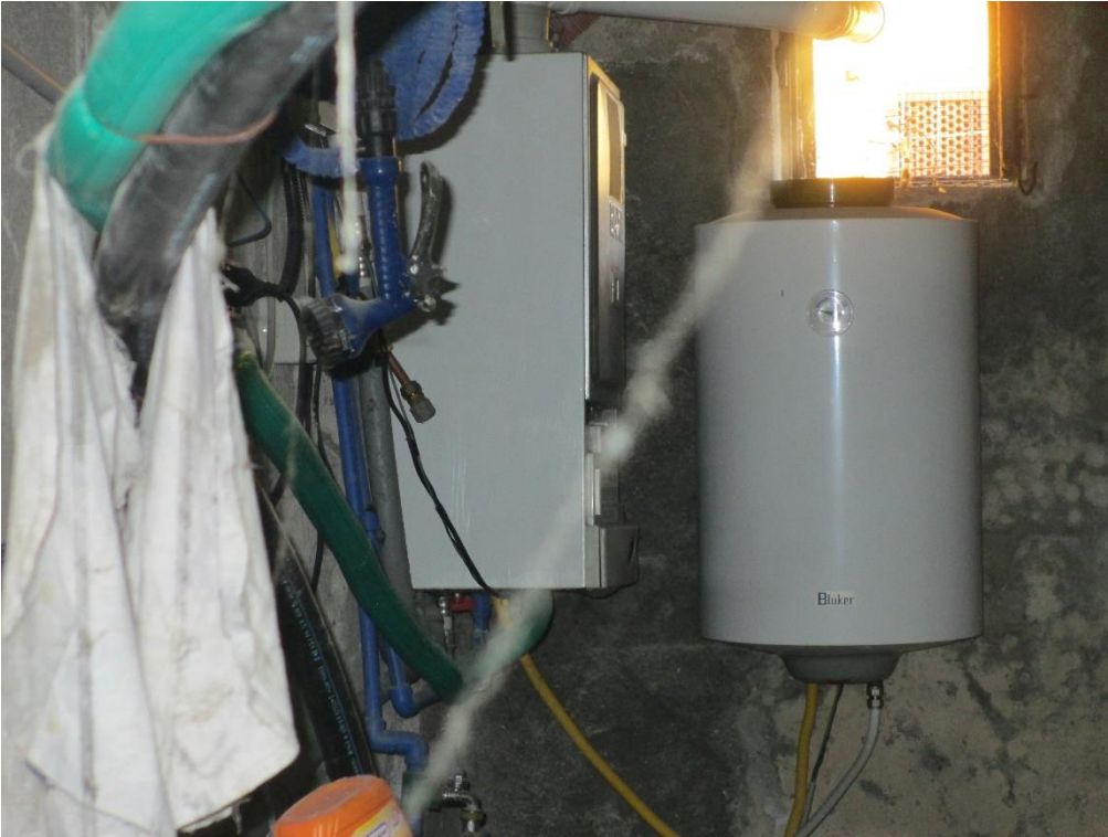
Foto 25: caldaia e serbatoio di accumulo per acqua calda
