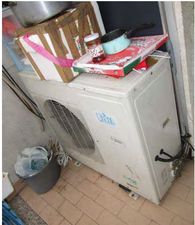
23. Macchina esterna per l'impianto di raffreddamento.
