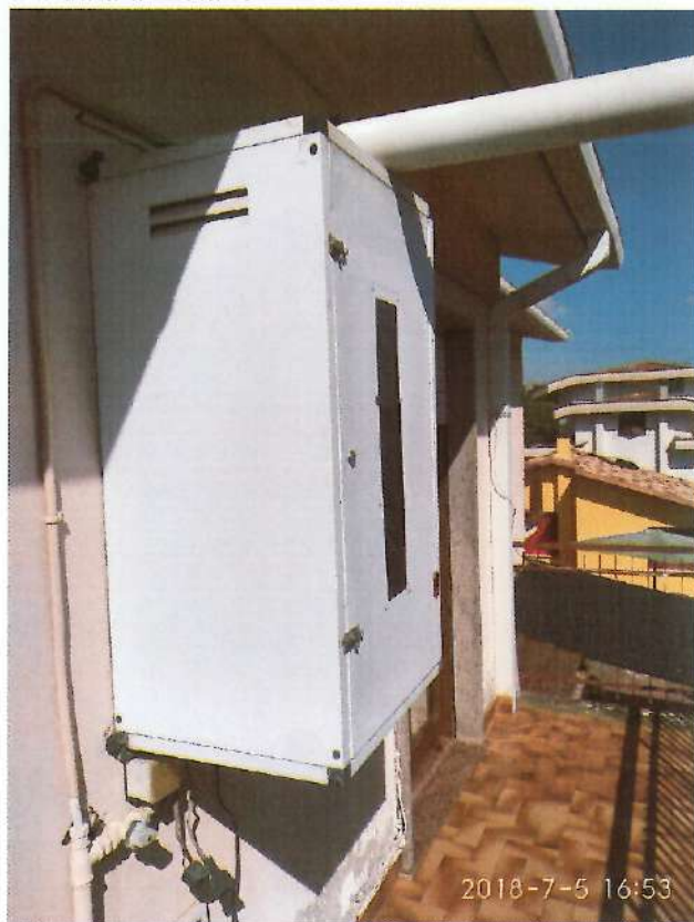
Caldaia a metano
