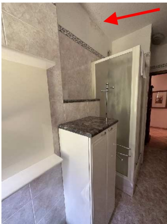
18. Vista delle infiltrazioni presenti nel bagno.
