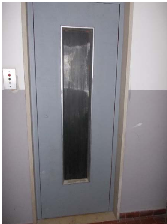
Ascensore non funzionante
