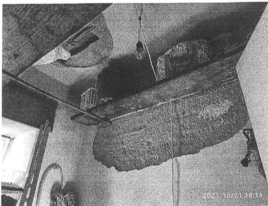
FOTO 9 – vista dell'ammaloramento delle pareti e del solaio.
