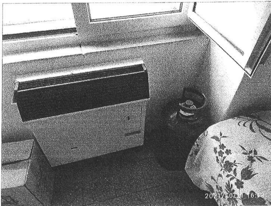
FOTO 8 – vista del termoconvettore alimentato con bombola a gas propano.
